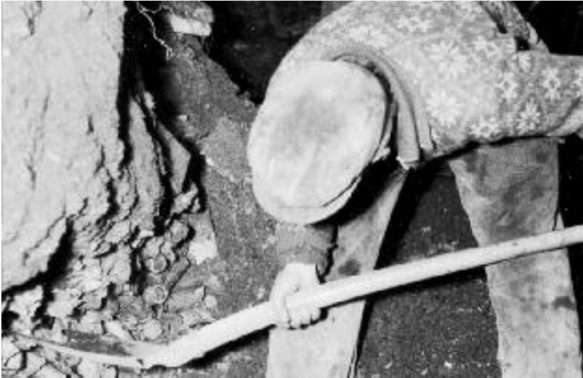
Ohne jegliche Schutzbekleidung gruben die Arbeiter die teilweise bis zu 80 Zentimeter dicken Schichten der Kampfstoffhülsen aus
